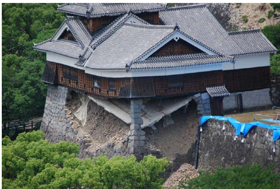
熊本地震で大きな被害を受けた熊本城。天守閣(上)と飯田丸五階櫓(下)
