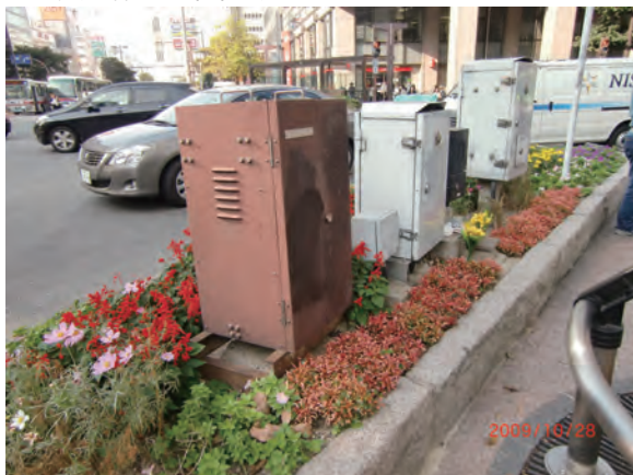
写真 84:天神交差点の花壇にさえも3つの変圧器で景観を壊している事例。多くの花壇で見られる。(天神 2009/10/28)
