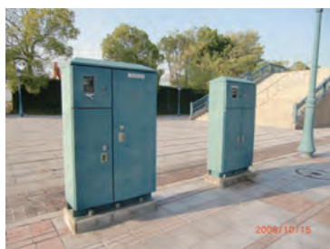
変圧器、街灯、手すりが同じ色
