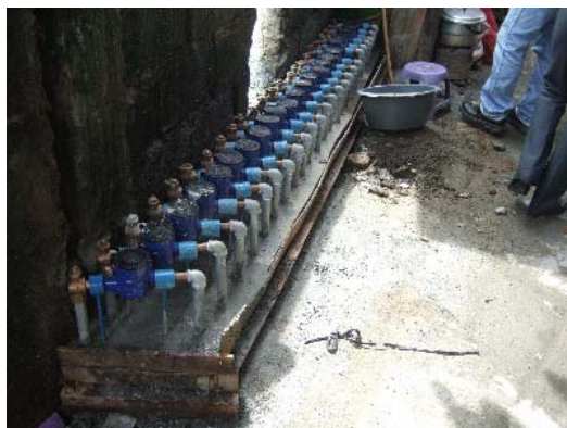
図 1-15 各戸接続後の水道メータ
