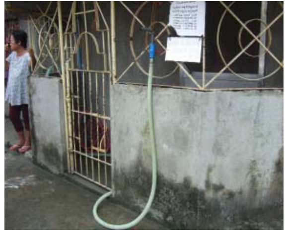
水道水栓の様子 水道整備により水栓を公共水栓的に利用している（ただし有料である）。
