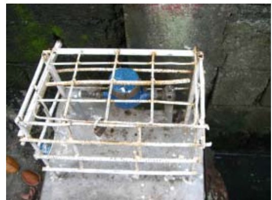
図 1-16 水道メータ改造防止策（鉄格子）
