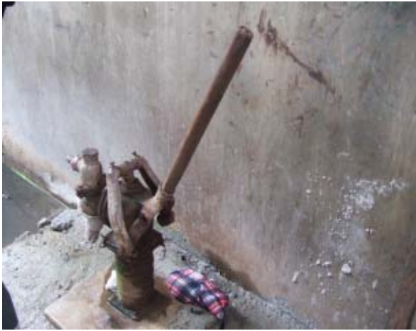
Kababan 地区にある井戸の様子 一部の住民は洗濯などに井戸を用いている。水道普及以前は、全住民が井戸や河川水、売り水に頼っていた。
