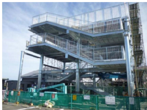
写真 6.4 焼津市津波避難タワー 出所 国土交通省
